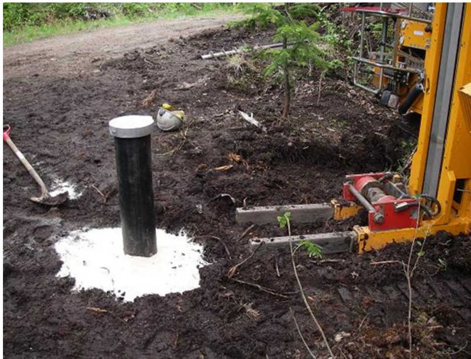
Photographie prise lors des travaux de forage sur le site d'enfouissement d'Armagh en 2017
